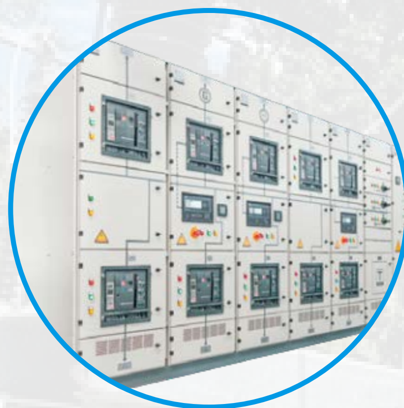
SWITCHGEAR – MCC Y TABLEROS ESPECIALES
