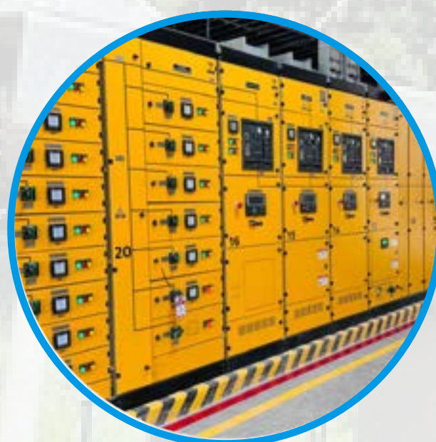
SWITCHGEAR - MCC Y TABLEROS ESPECIALES
